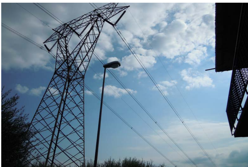
L'elettrodotto da 380 kV (in entrambe le foto) posizionato nel rione Passo Vela a pochi metri dalle abitazioni
