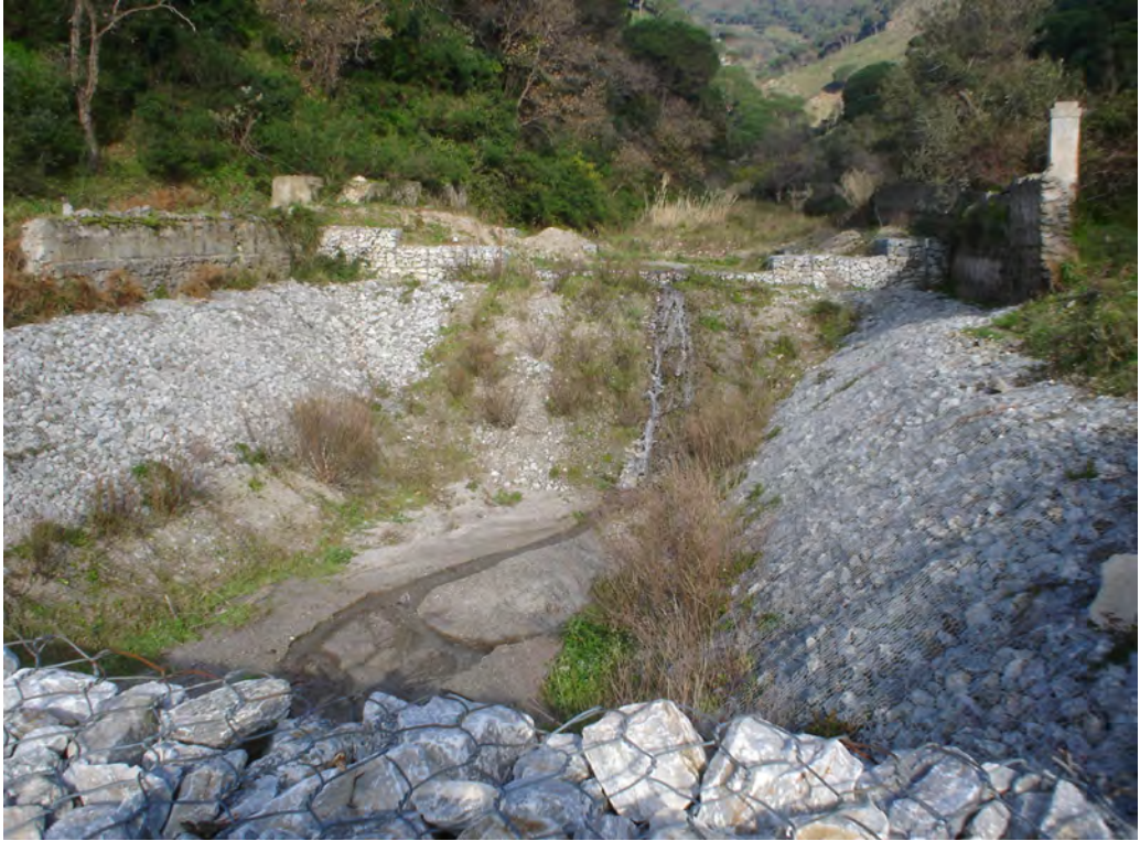
Fig.5 - Vasca di contenimento della Fiumara Ciccia (Monti Peloritani di N.E.) realizzata dopo una serie di piene calamitose a protezione di insediamenti recenti (polo universitario e impianti sportivi). (Foto P. Mazzeo)
