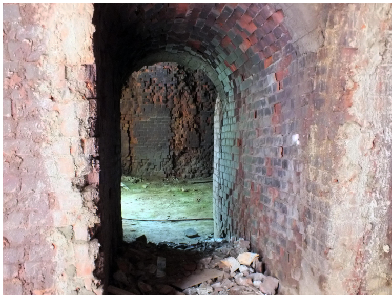
FIGURA 5A. Struttura interna della fornace Hoffmann di Venetico. Photo by M. Franzone.
